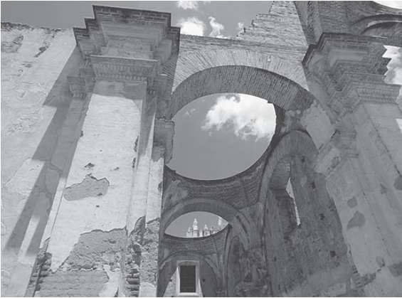
カテドラルの裏側の地震の痕跡
